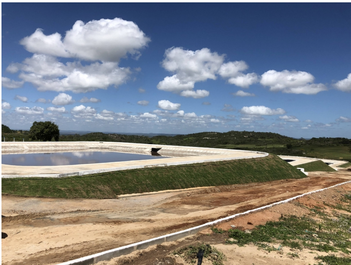
Figura 13 – Lagoas de estabilização
